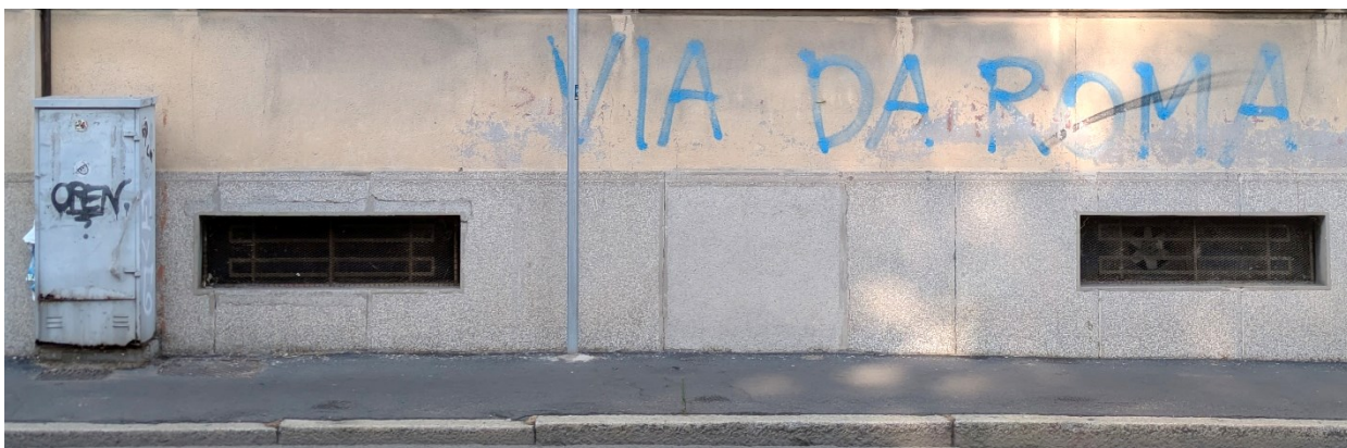
Graffiti da rimuovere e griglie metalliche oggetto di intervento manutentivo – Via Cadorna
