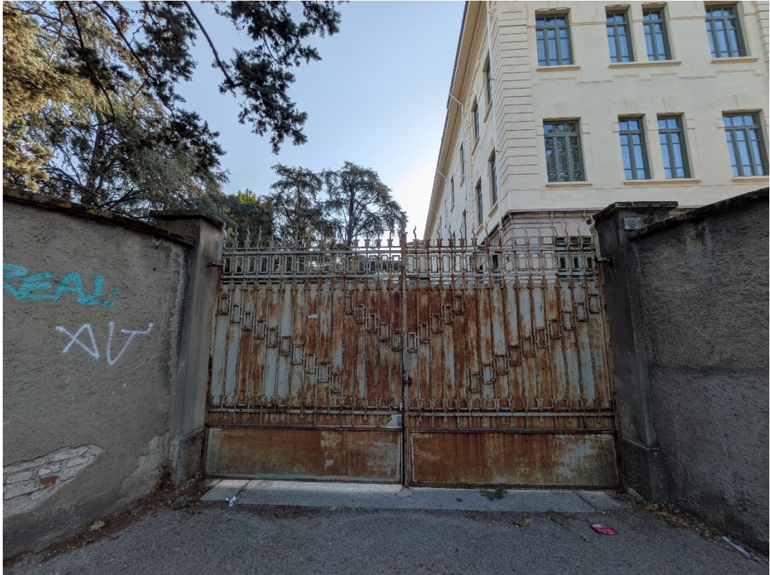
Cancello metallico oggetto di intervento manutentivo – Corso A. Garibaldi
