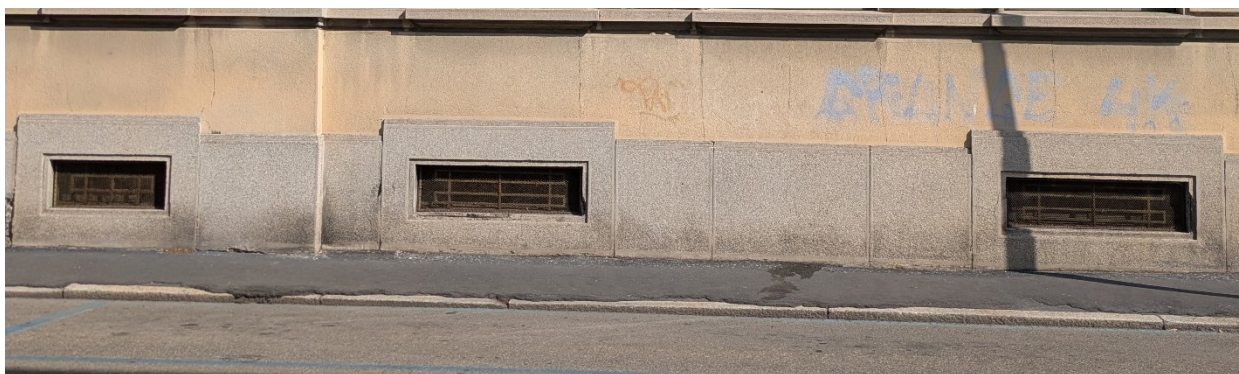
Graffiti da rimuovere e griglie oggetto di intervento manutentivo – Via Diaz
