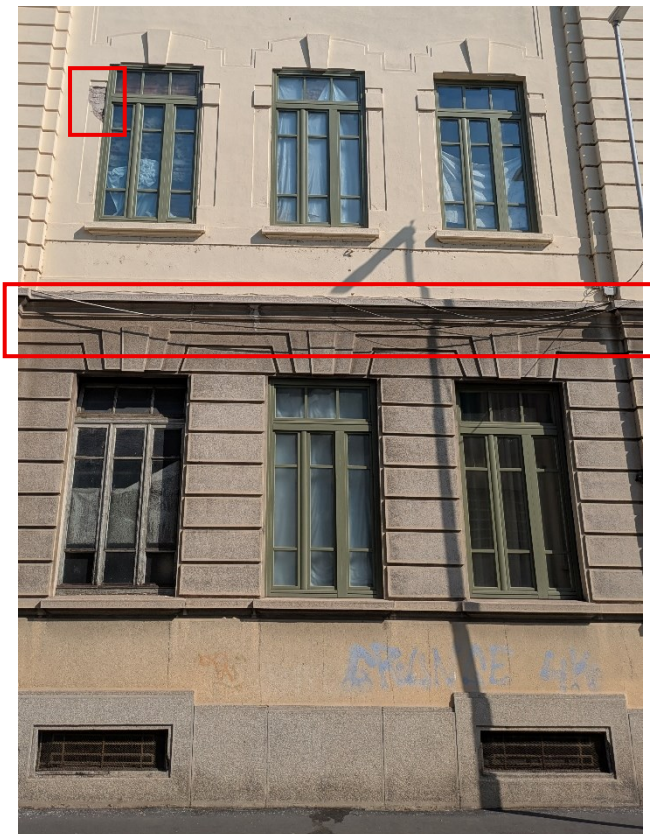
Spalletta da risanare e cavi da fissare – Via Diaz
