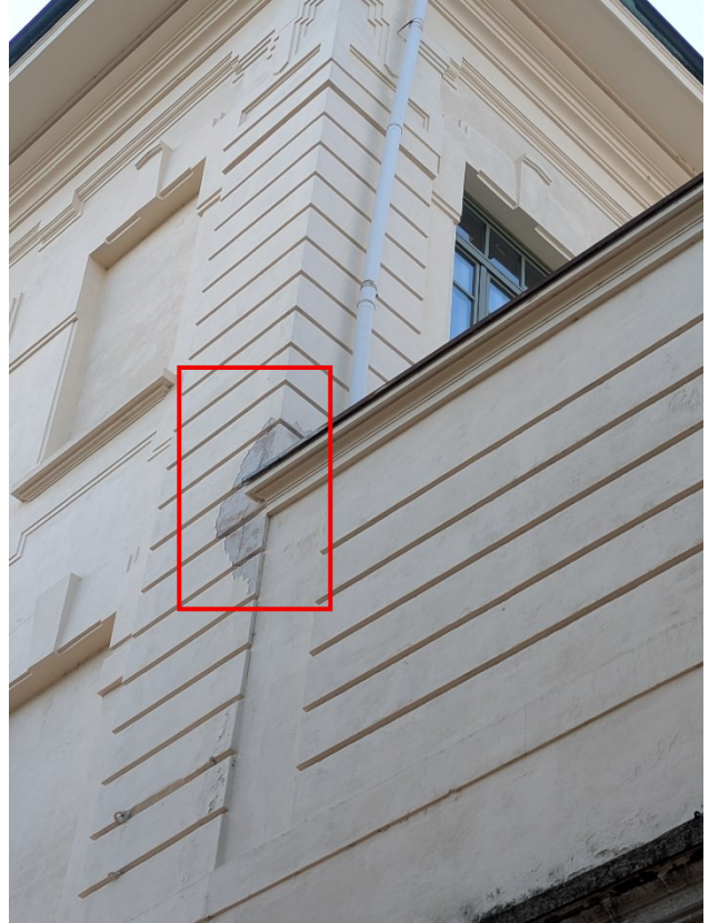
Intonaco da ripristinare – Corso G. Garibaldi
