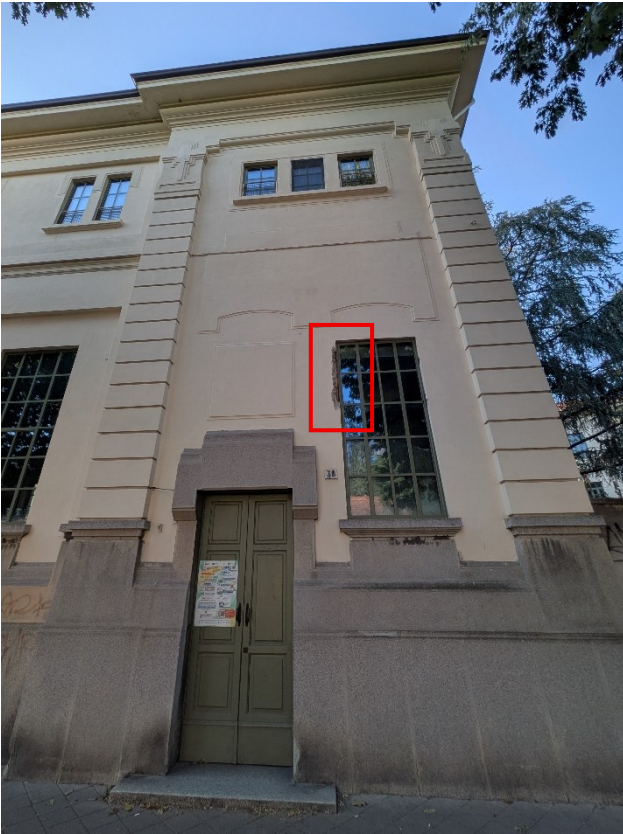
Spalletta da risanare – Corso G. Garibaldi
