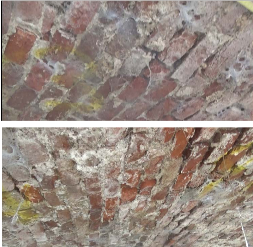
Fig. 2.1.4 – I giunti di malta sull'arco sono in discreto stato, con qualche zona dove si è avuta una erosione centimetrica
